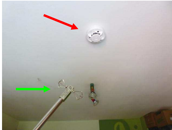
An der Zimmerdecke montierter Funk-Rauchwarnmelder und Messantenne
