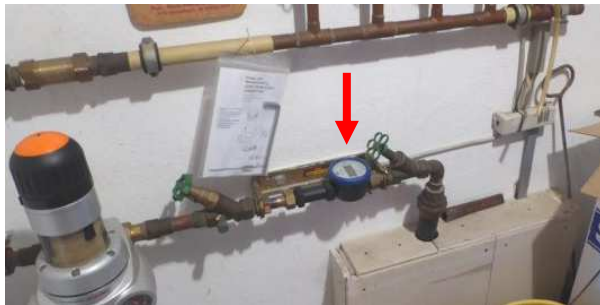
Kellerraum mit Haushaltswasserzähler
